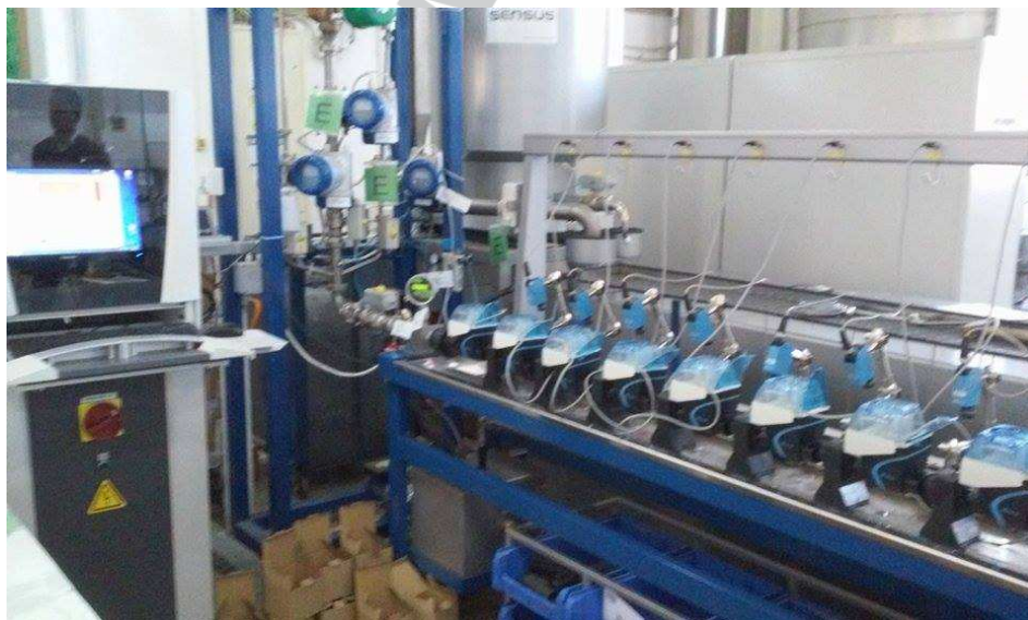
Instalatie de verificare metrologica a contoarelor din cadrul laboratorului SC Apa Nova Bucuresti SA
